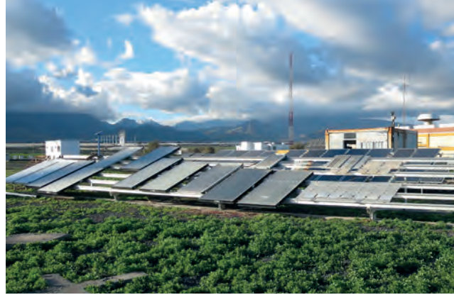
Test stand on the premises of the Instituto Tecnológico de Canarias (ITC) in Pozo Izquierdo, Gran Canaria, Spain.
