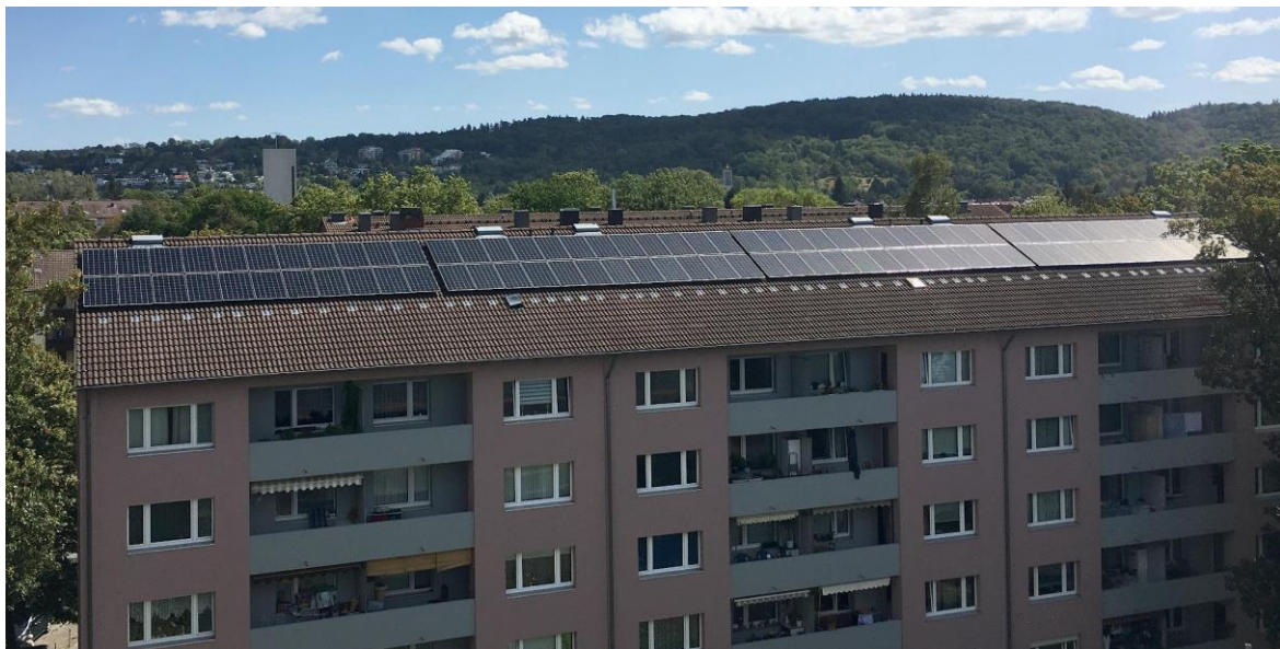
Abb. B1-2: PV-Anlage (4 Felder), westliche Dachseite, Ersinger Straße 4 (Sommer 2021). Wie ersichtlich, hätte man auch mehr als 30 kW p auf diesem Dach installieren können (s. auch Abbildung auf der Titelseite). Bildquelle: M. Lämmle/Fraunhofer ISE.
