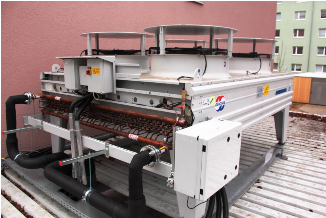
Abb. B1-6: Tischkühler als Teil der Mehrquellenanlage der Viessmann-Wärmepumpe (gemeinsame Entwicklung von Viessmann und Fraunhofer ISE) auf dem Müllhäuschen an der Ersinger Straße 4.
