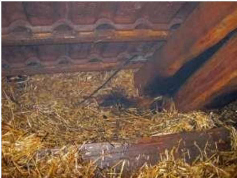
Figura 3-33: Caso leve de incendio (Foto: Cuerpo de bomberos de Ellwangen)
