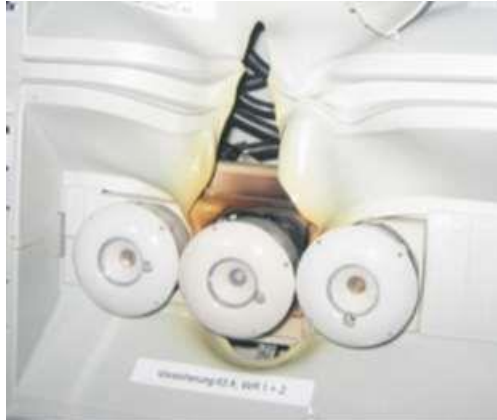
Figura 3-30: fusible sobrecalentado (Foto: H. Godard, Energossa)
