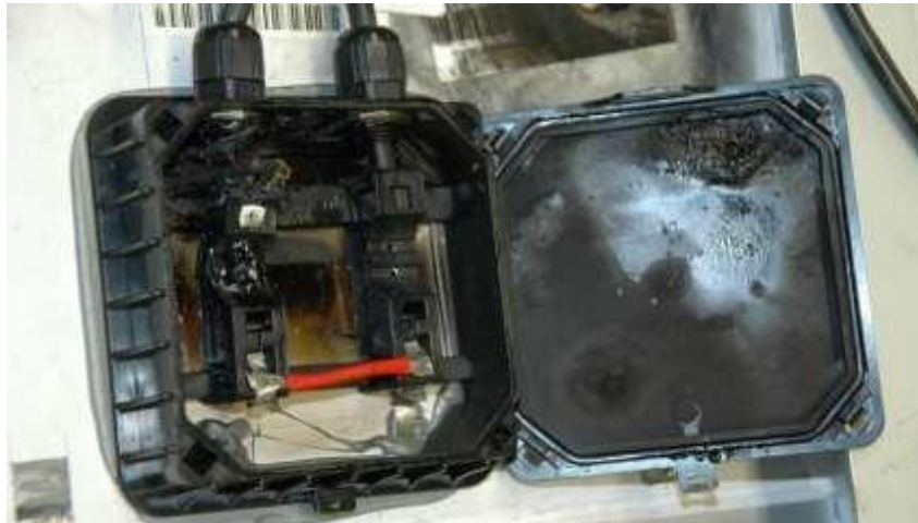
Figura 3-43: Caja de conexiones después de un arco eléctrico entre el cable de conexión y el terminal de conexión [5].
