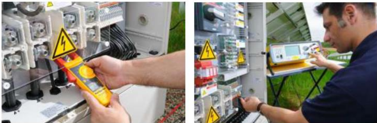
Figura 5-33: Mediciones en las cadenas del generador, en la caja de bornes
