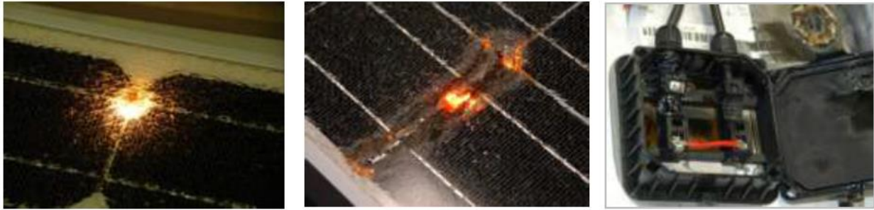
Figura 3-6: Arcos eléctricos en módulos FV, fotos: TÜV Rheinland.
