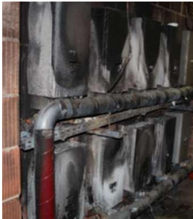
Figura 3-23: Recinto técnico de una planta FV después de un incendio.
