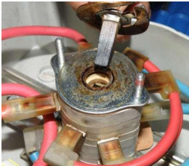
Figura 3-24: Huellas claras de sobrecalentamiento en las conexiones y en el interior de un interruptor que “sobrevivió”.
