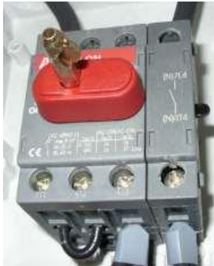
Figura 3-26: interruptor principal CC tipo palanca probado.
