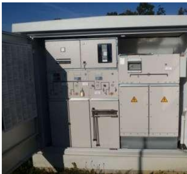
Figura 5-41: Estación de media tensión
