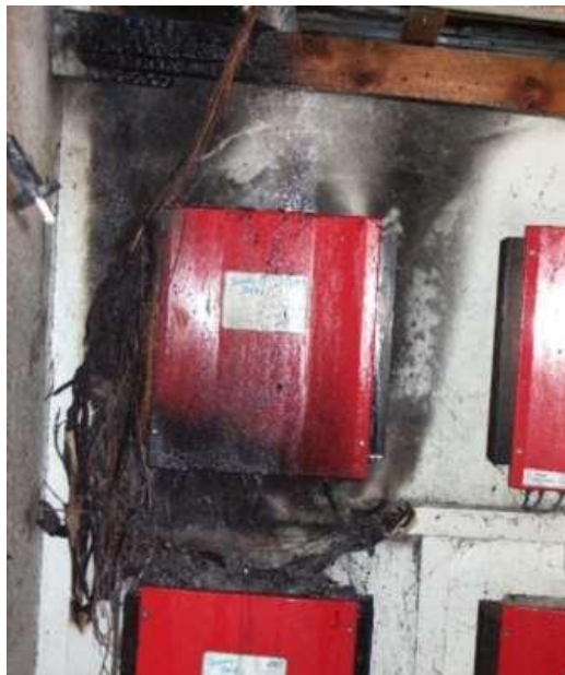
Figura 3-31: Conductores quemados de un inversor (Fuente: Cuerpo de bomberos de Weyerbusch)
