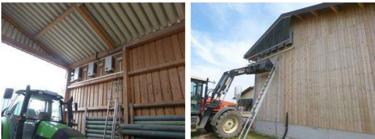
Figura 3-14: La instalación incorrecta de inversores sobre madera no cumple con la seguridad contra incendios, además, es difícil de alcanzar para el mantenimiento. Fotos: W. Schröder, experto FV, 2014.
