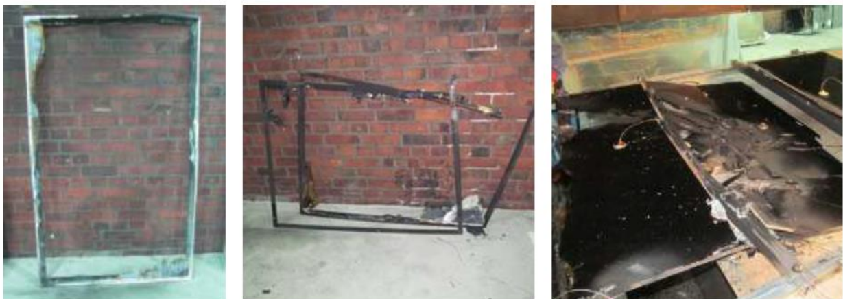
Figura 3-3: Daños después de una solicitud con 150 kW de potencia del quemador, a la izquierda, c-Si, en el centro, CIS (puesto en sentido transversal) y a la derecha, CdTe (puesto en sentido transversal).
