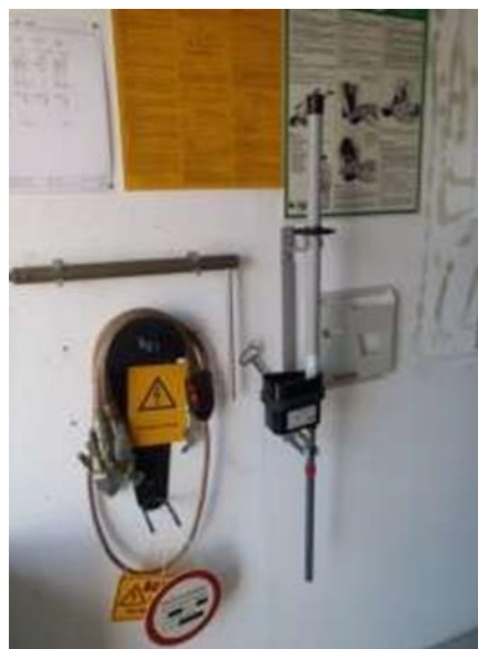
Figura 5-42: Kit de contacto a tierra y cortocircuito para el transformador
