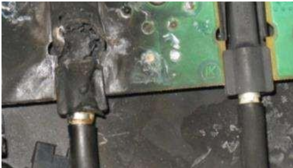
Figura 3-27: Contactos enchufables dañados, en una caja de conexión del módulo.
