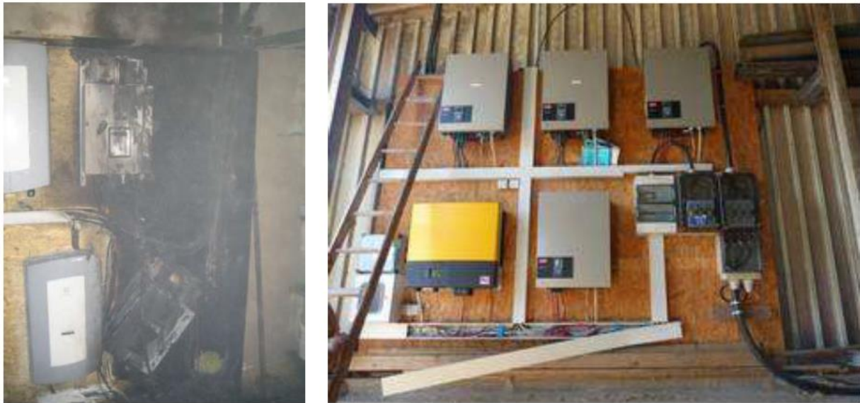
Figura 3-32: Montaje del inversor en tableros de madera OSB; a la izquierda, aquí fue lo ocurrido. Foto: Voluntarios del cuerpo de bomberos del municipio de Perl, 2011. A la derecha: aquí luce bien a la vista, pero no está acorde con la normativa de protección contra incendios. Foto W. Schröder, experto en FV, 2014.
