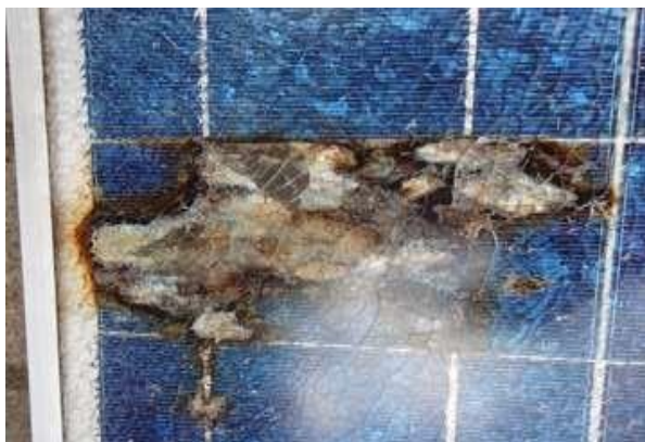
Figura 3-46: Daño directo por un rayo en una planta de 10 años (Fuente: Photovoltaik-Büro Ternus & Diehl GBR)
