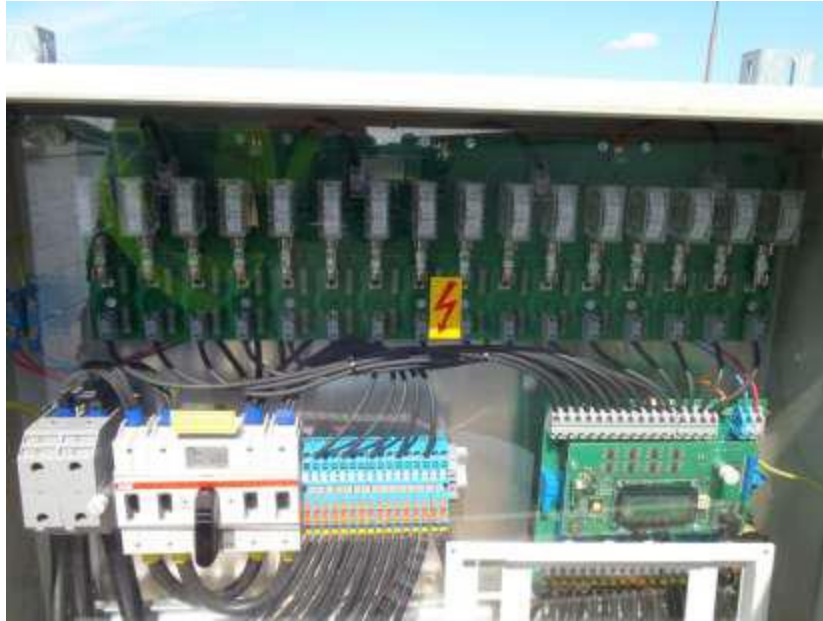
Figura 5-37: Caja de toma de corriente de generador con interruptor bajo carga y bornes de separación
