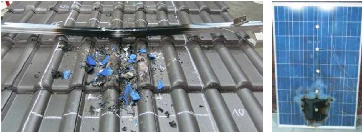
Figura 5-32: Resultado después de la prueba. Se destruyó el módulo, el fuego no traspasó la superficie del techo
