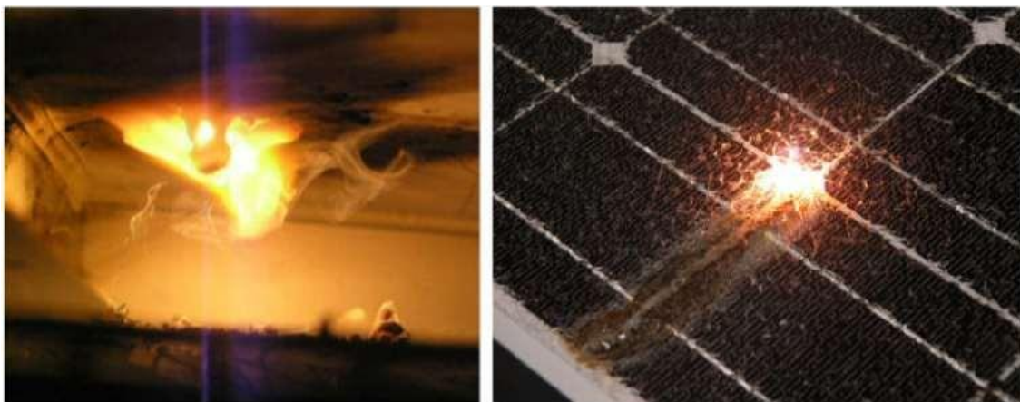
Figura 3-42: Repercusiones de un arco eléctrico provocado al separar conductores de celdas. Fotos: TÜV Rheinland.
