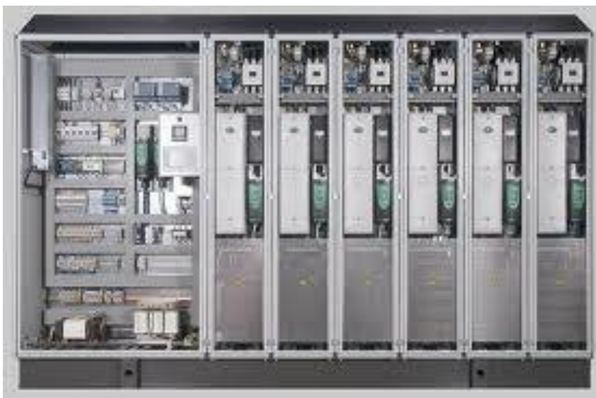
Bild 3-55: Beispiel eines Zentralwechselrichters in einem Schaltschrank
