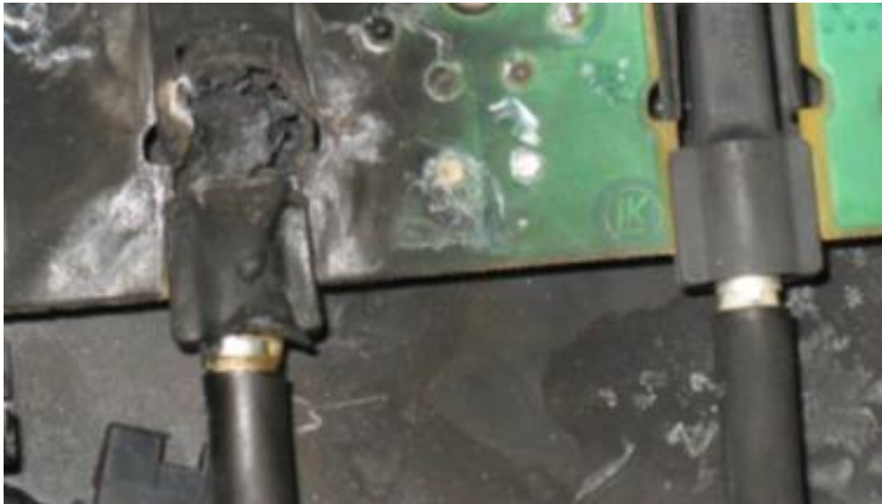
Bild 3-27: Beschädigte Steckkontakte in einer Modulanschlussdose
