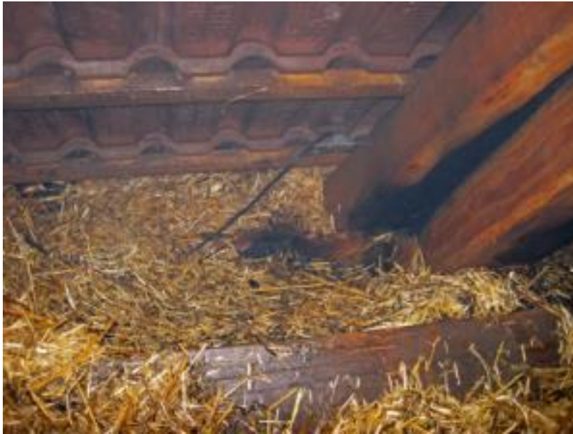
Bild 3-33: Glimpflich verlaufener Brandfall (Foto: Feuerwehr Ellwangen)
