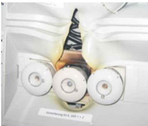
Bild 3-30: Heiß gewordener Sicherungseinsatz (Foto: H. Godard, Energossa)
