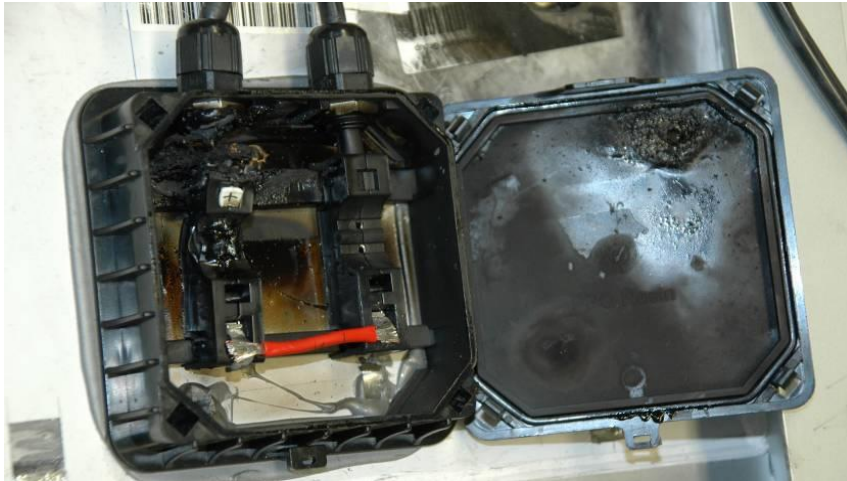
Bild 3-43: Anschlussdose nach Lichtbogen zwischen Anschlussleitung und Anschlussklemme [5]
