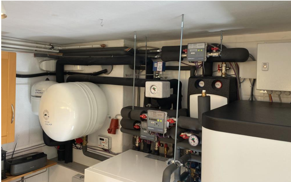
Wärmepumpenanlage und Speicher mit Wärmemengenzählern in der Hydraulik. © Fraunhofer ISE
