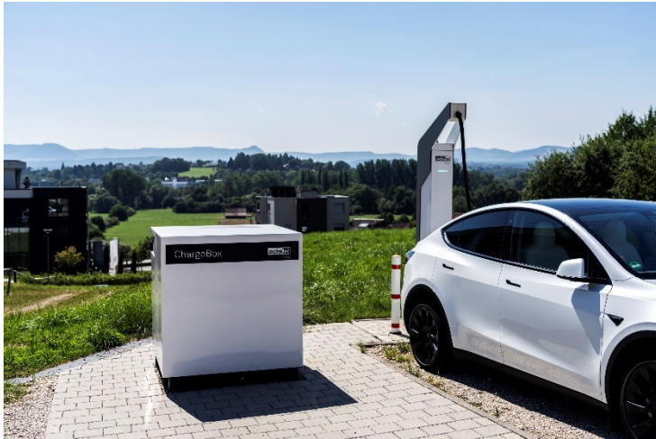
Die ChargeBox erlaubt das Schnellladen von bis zu zwei Fahrzeugen an einer Ladesäule auch bei einem leistungsbegrenzten Netzanschluss. © Deutscher Zukunftspreis
