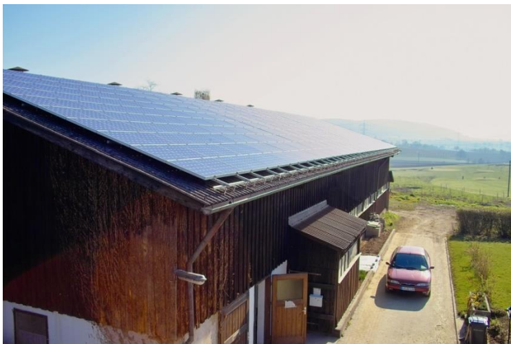
Alte Photovoltaik-Anlagen, wie dieses 30 Kilowatt große System auf einem Landwirtschaftsgebäude, fallen in den nächsten Jahren aus der EEG-Förderung. © Fraunhofer ISE/triolog
