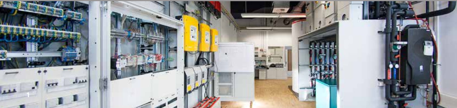
1 Innenansicht des SmartEnergyLab am Fraunhofer ISE.
